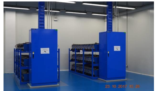
งานระบบไฟฟ้าสำรอง (UPS)
