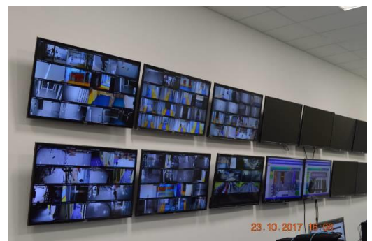
งานระบบโทรทัศน์วงจรปิด
